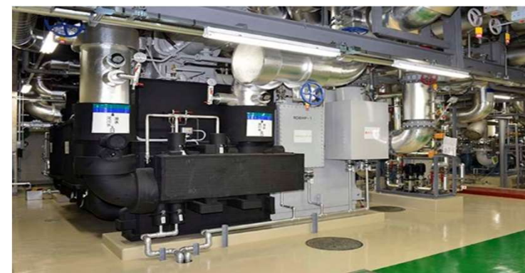
河川水利用ヒートポンプ
