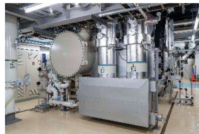
下水処理水利用ヒートポンプ
