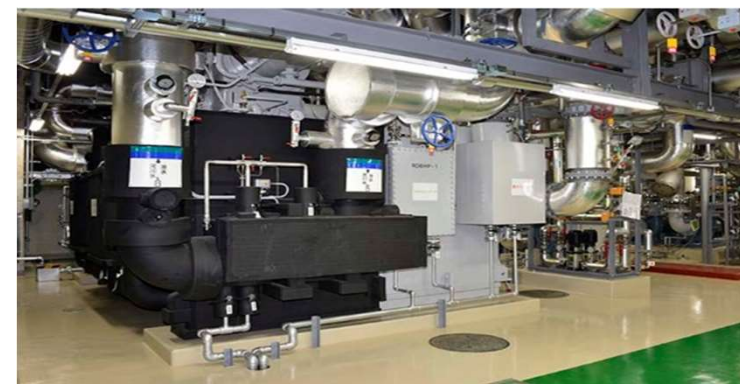
河川水利用ヒートポンプ
