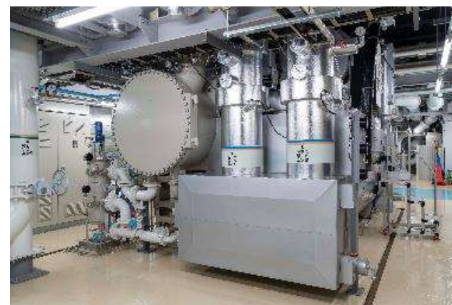
下水処理水利用ヒートポンプ
