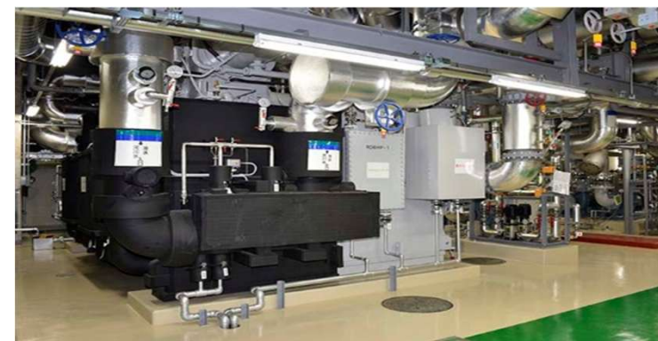
河川水利用ヒートポンプ
